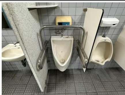
綜合大樓廁所小便斗扶手
