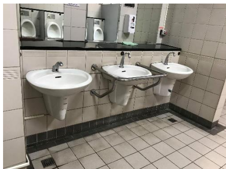
第二教研大樓廁所洗手台扶手
