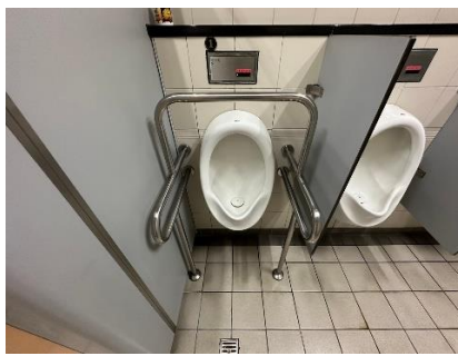
第一教研大樓廁所小便斗扶手
