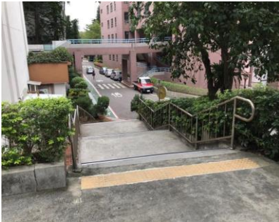
教師研究二樓右側樓梯 扶手及防滑設施
