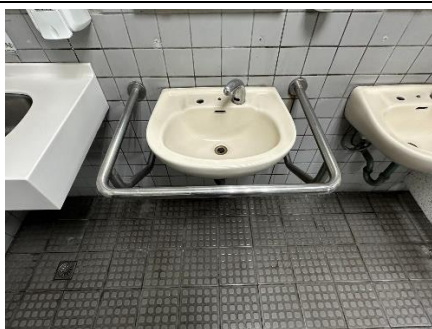
綜合大樓廁所洗手台扶手
