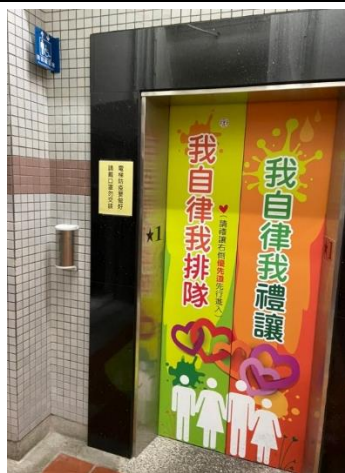
綜合大樓無障礙電梯
