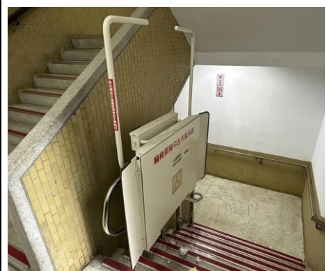
第二大樓側門入口樓梯往 B1 樓層的輪椅升降平台
